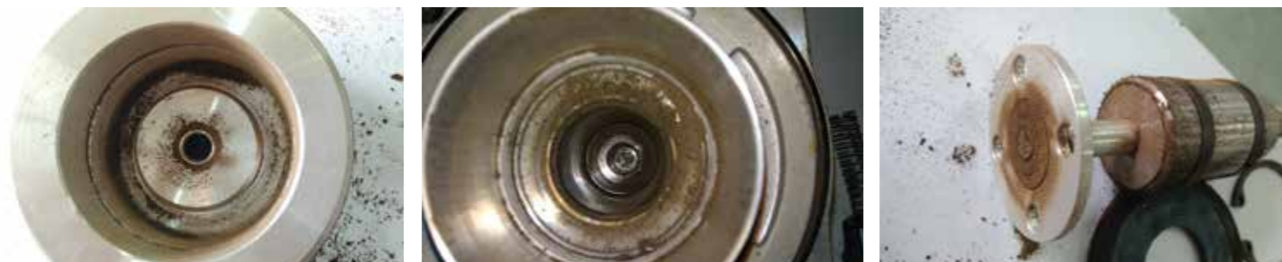
Рис. 1. Загрязнение внутренних элементов арматуры
